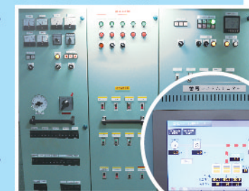
蓄電システム
